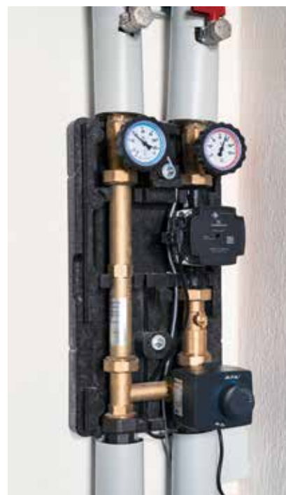
Kompakt und sauber: Der Einbau der Heizungspumpengruppe ist ebenfalls schnell und unkompliziert durch das Fachhandwerk möglich.
